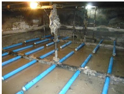
調整槽 微細気泡発生装置 他
