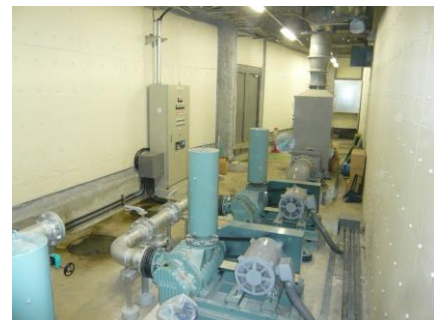
機械室 フロアーポンプ 他
