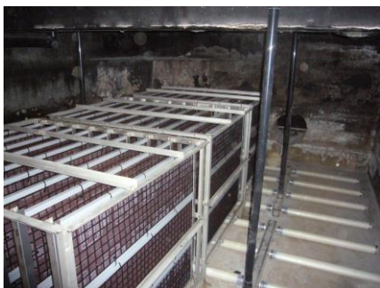
バイオ処理槽 特殊バイオフィルター 他
